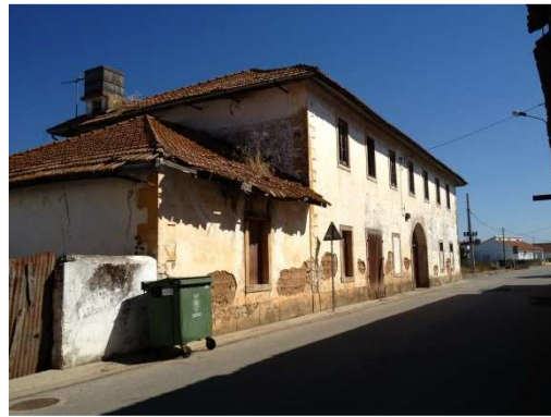
Figura 2 – Edifício em mau estado de conservação, Antiga Adega - Junta de Freguesia do Pombalinho
