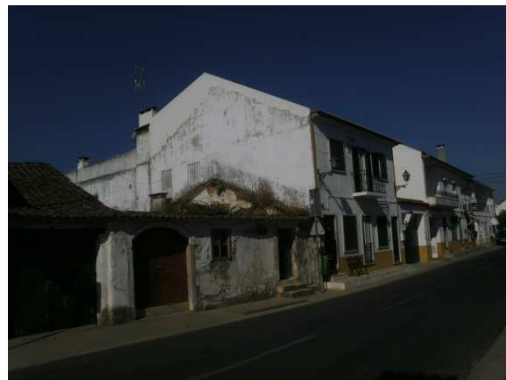
Figura 6 – Arruamentos ladeados por edifícios em degradação
