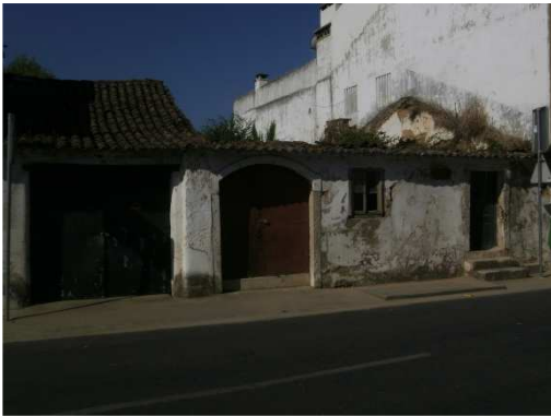
Figura 3 – Edifícios em mau estado de conservação
